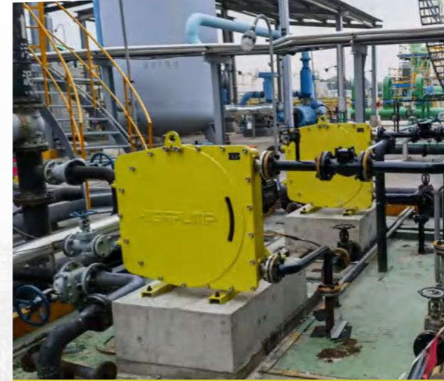
中海油泰州石化油泥浮渣输送泵
